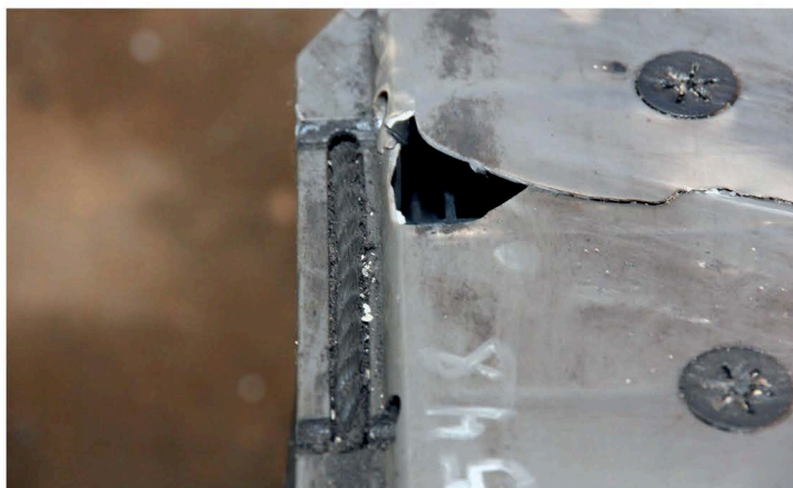
▲ Еще один характерный пример разрушений аккумуляторной батареи от взрыва. Данная АКБ так же ремонту не подлежит
