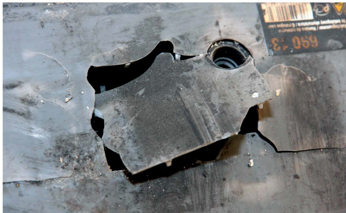
▲ Последствия взрыва аккумулятора – разрушенная крышка. Батарея взорвалась вследствие скопления газов. Ремонту данная АКБ не подлежит
