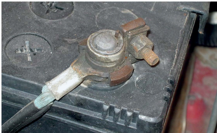
▲ Для нормальной работы АКБ важен хороший контакт с электропроводкой. Мастера «компенсировали» разницу в диаметре установкой... гвоздя
